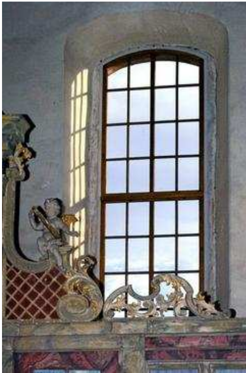
So schön sehen die 13 neuen Fenster aus, die nach der Originalvorlage entstanden und jetzt eingebaut wurden. (MZ-Foto: Peter Wölk)
