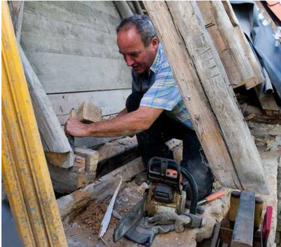
Ulrich Lehmann arbeitet am verrotteten Dachstuhl der Kirche St. Wenzel in Langeneichstädt. (FOTO: PETER WÖLK)
